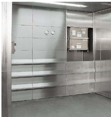
Filtertechniek in de achterwand
